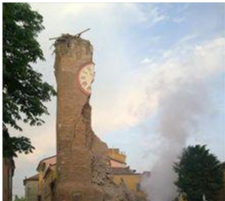
Un campanile fortemente danneggiato.
